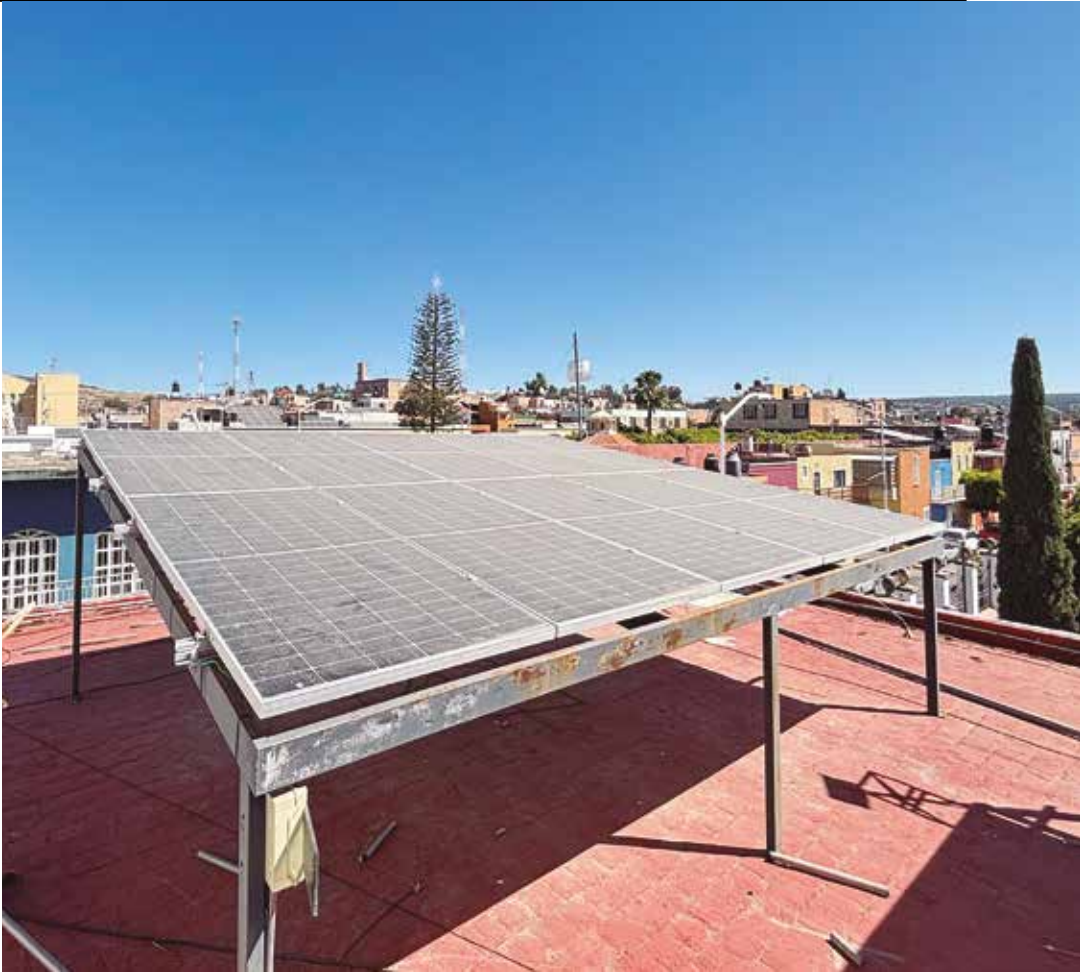
En transición energética, Jalisco lidera nacionalmente en generación distribuida (paneles solares en hogares, empresas y comercios), con casi 40% más capacidad que el segundo lugar. Esto refleja un avance significativo en autonomía energética ciudadana y empresarial.
