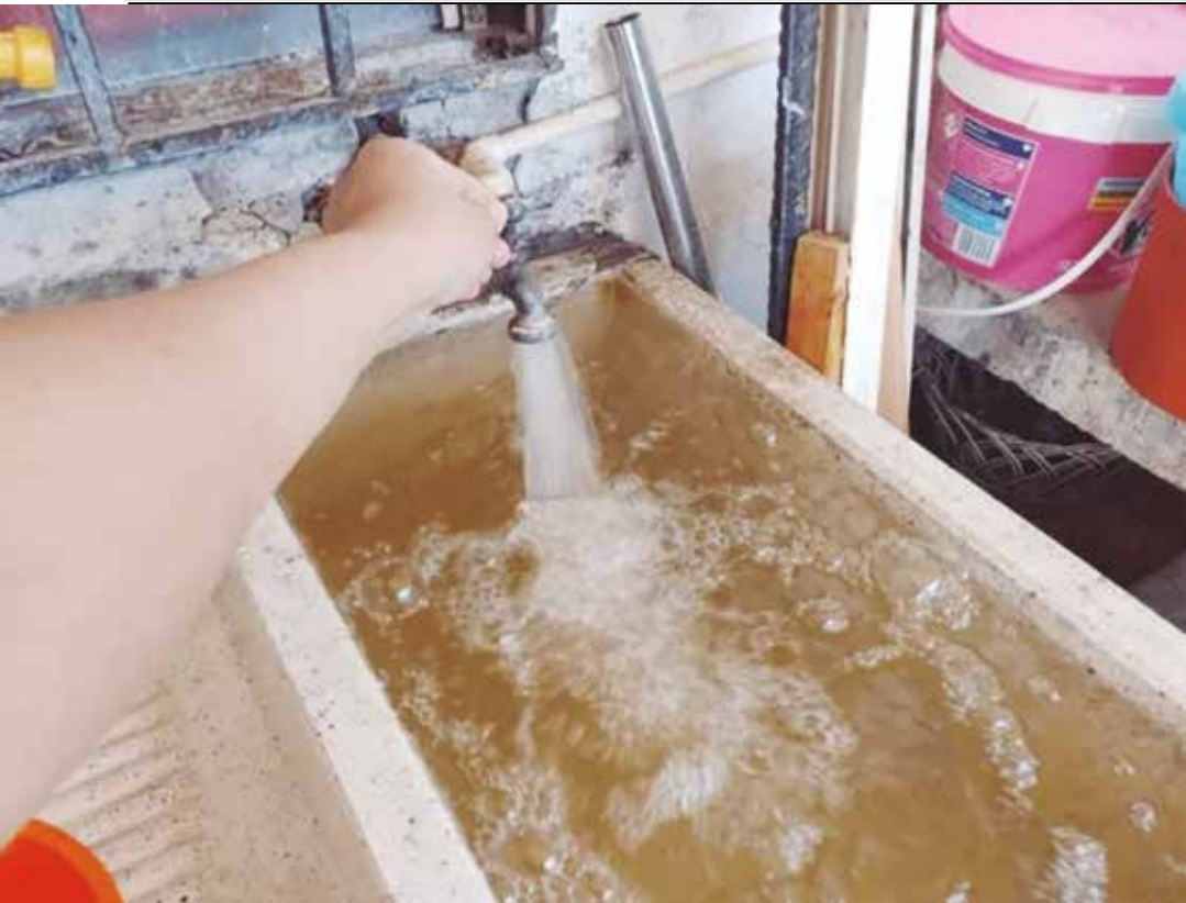
En decenas de colonias de la metrópoli sale agua turbia y olores fétidos de la tubería del SIAPA.
