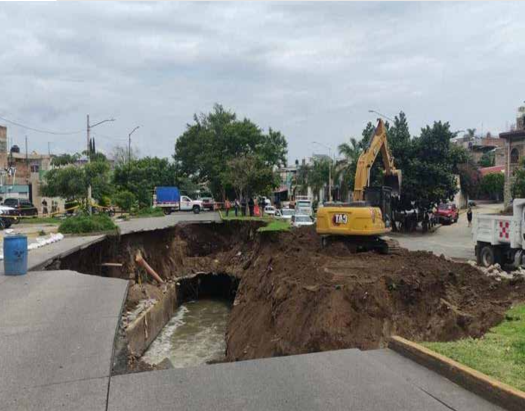
El deterioro de la infraestructura hidrosanitaria se ha hecho visible con la aparición de socavones en distintos puntos de la Zona Metropolitana de Guadalajara
